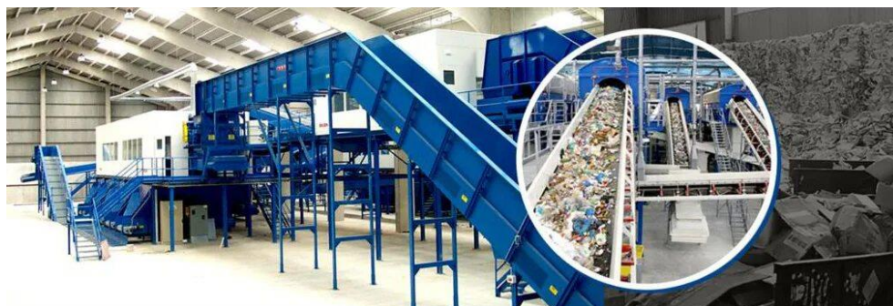
Рис. 7. Мусоросортировочном завод, оснащенном оборудованием турецкой компании MT Makina.
